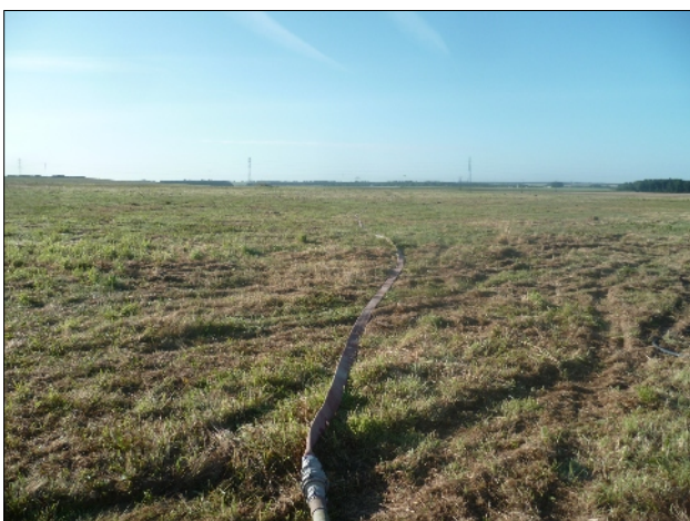
Tuyau d'exhaure du pompage
