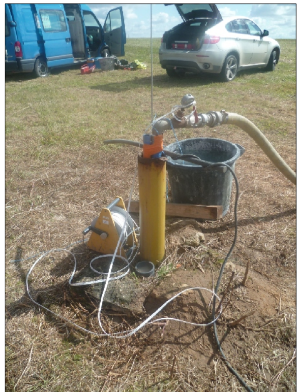
Pompe 4" installée sur le forage agricole
